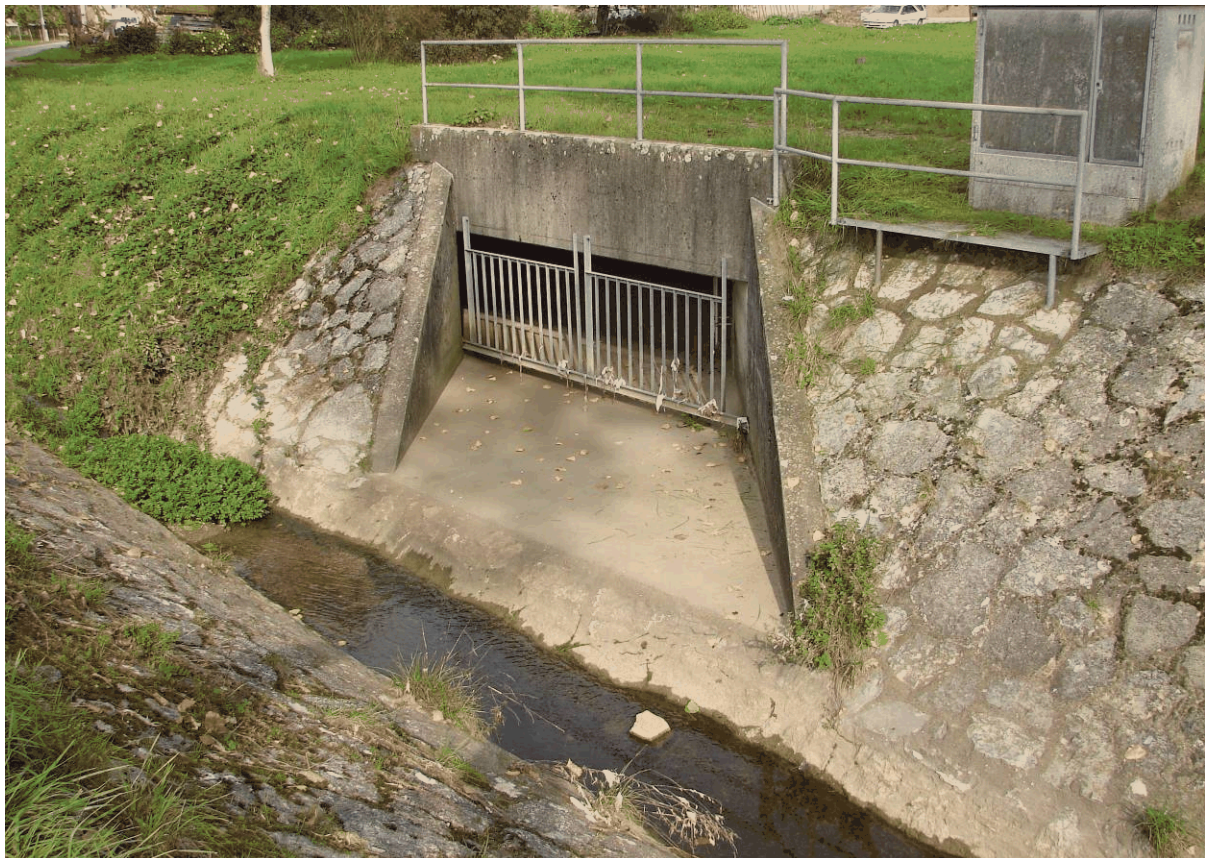
Abb. 5.2.3a Regenklärbecken Empützigraben in Hallau
