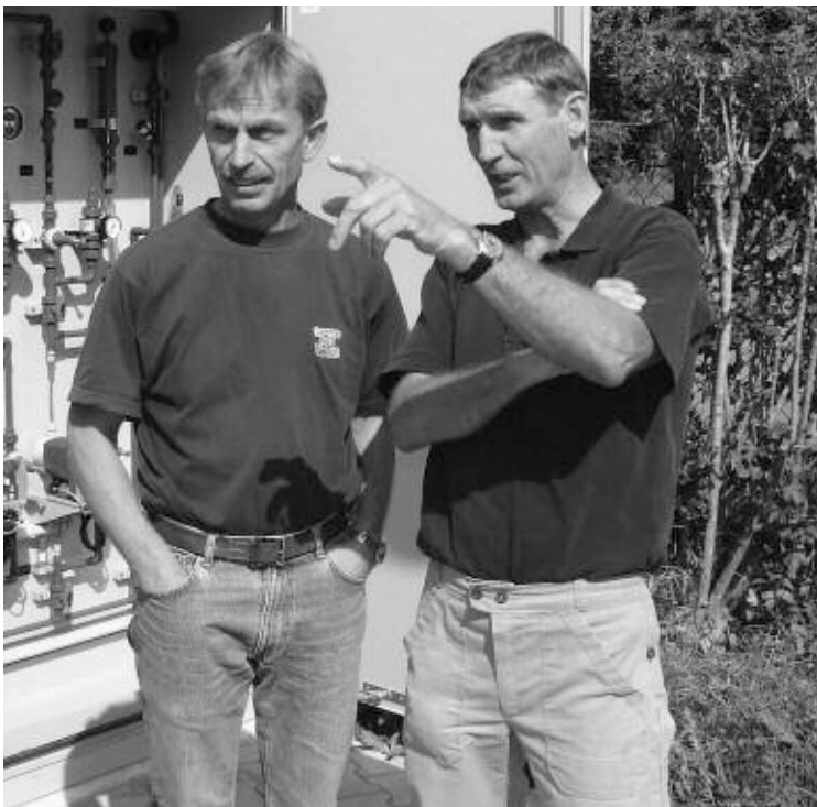
Vor der neuen Fällmittelstation für Phosphat diskutieren Klärmeister Helmut Güntert (links) und der Dörflinger Gemeinderat Werner Aeschlimann über Sicherheitsmassnahmen auf dem Gelände der Kläranlage. Fotos S. 23 und 24: R. Bombardi
