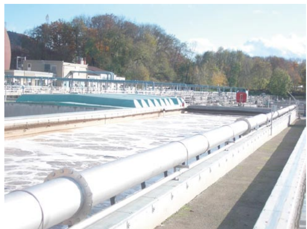
Das Prozesswasserbecken auf der ARA Bibertal-Hegau trägt zur Entspannung der Auslastung bei.
