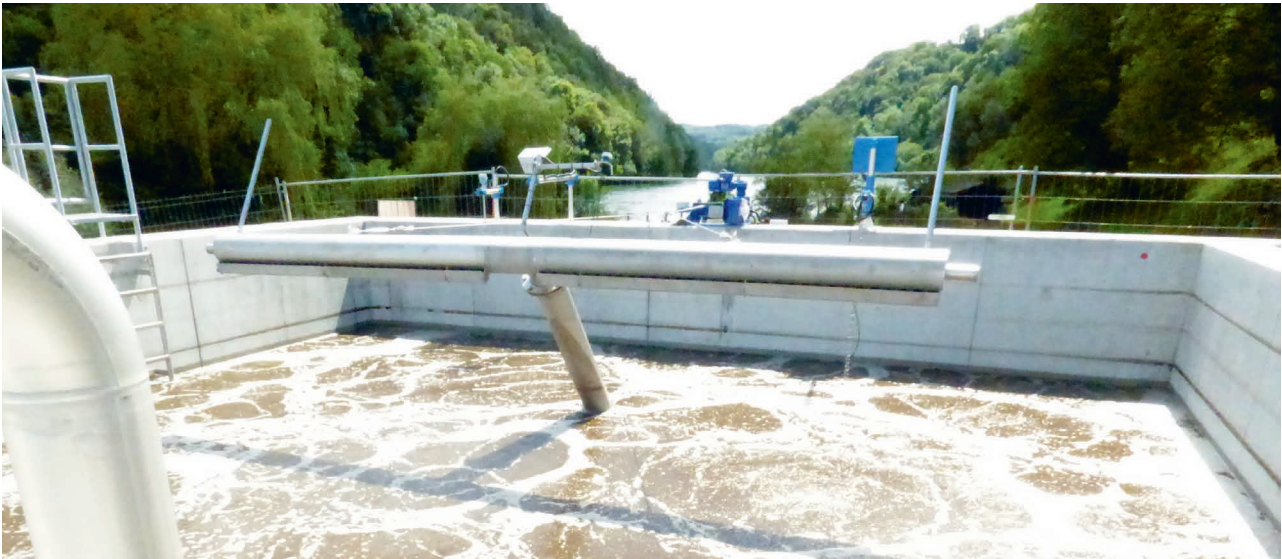
Das neue Herzstück der ARA Rüdlingen-Buchberg: einer der beiden SBR-Reaktoren. Foto: R. Bombardi
