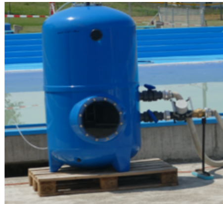
Behandlung mit Aktivkohlefilteranlage. Foto: Bo
