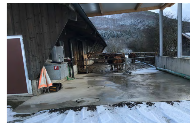
Ein neu erstellter, überdachter Füll- und Waschplatz für Pflanzenschutzmittel, der die Gewässer vor möglichen Einträgen schützt. Foto: PW
